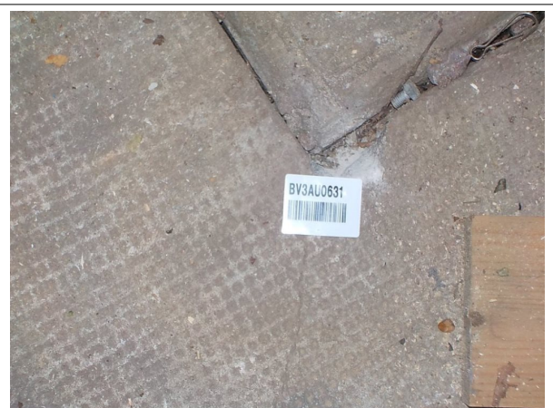
Prélèvement - PM5 : Garage et cave - Chape maigre- (Absence d'amiante)
