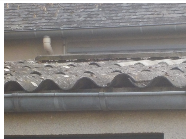
Prélèvement - PM7 : Garage et cave - Plaque- (Présence d'amiante)
