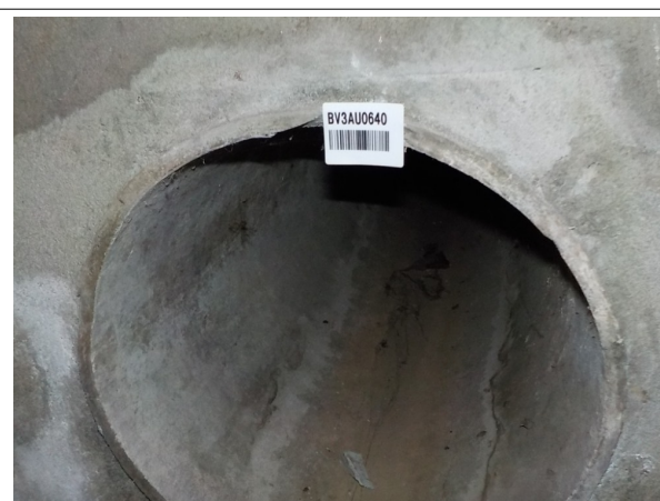
Prélèvement - PM14 : Chaufferie - Conduit- (Présence d'amiante)
