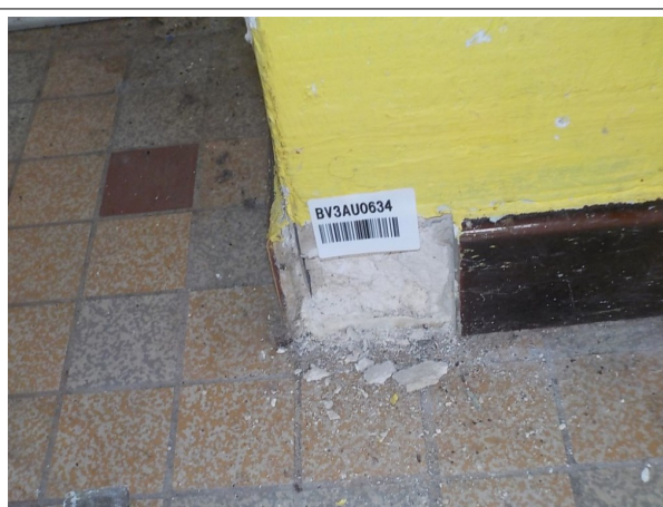
Prélèvement - PM8 : Classe 3 - Colle- (Absence d'amiante)
