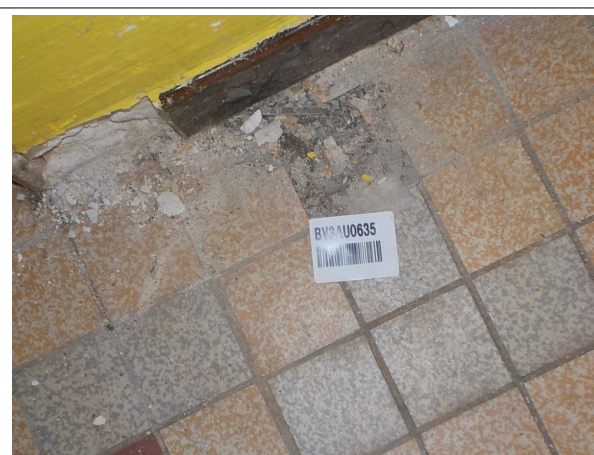
Prélèvement - PM9 : Classe 3 - Colle- (Absence d'amiante)
